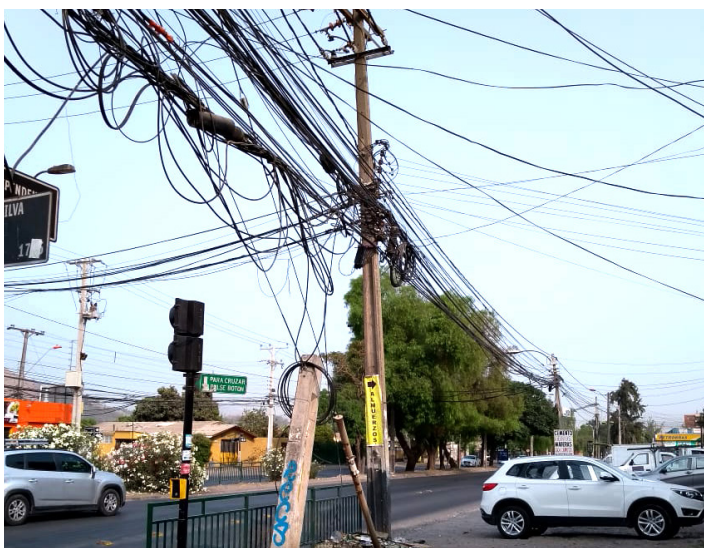
En algunas comunas la mantención al sistema eléctrico es deficiente.
